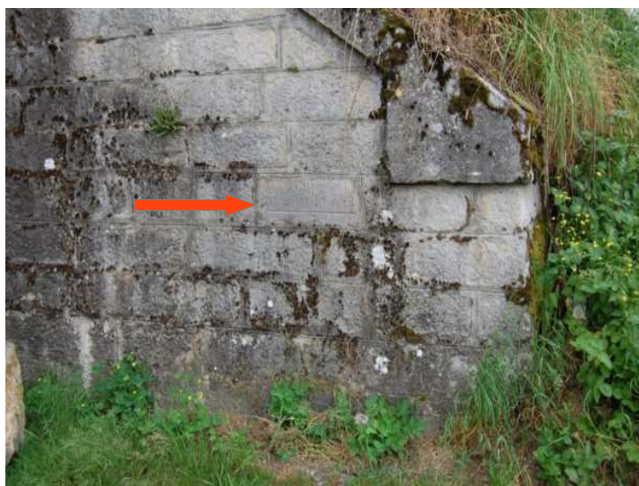
Photo n° 2 : Commune de Montréjeau, le pont SNCF. Le repère de la crue du 23/06/1875 à la cote 417.91 m.
