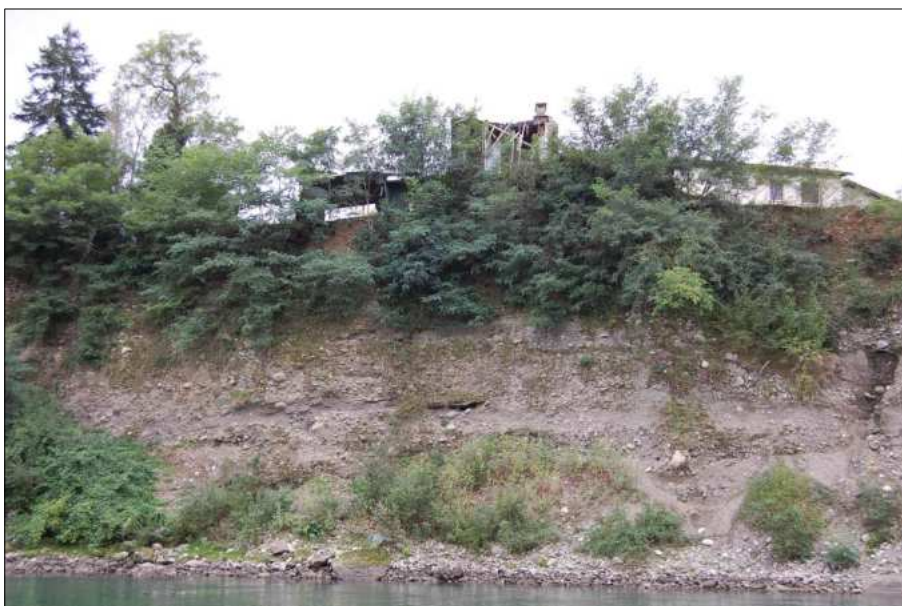
Figure n° 20 : commune de Pointis-de-Rivière, sous le bourg de Pointis-de-Rivière Lors de la crue du 18 juin 2013, il y a eu un effondrement du talus.
