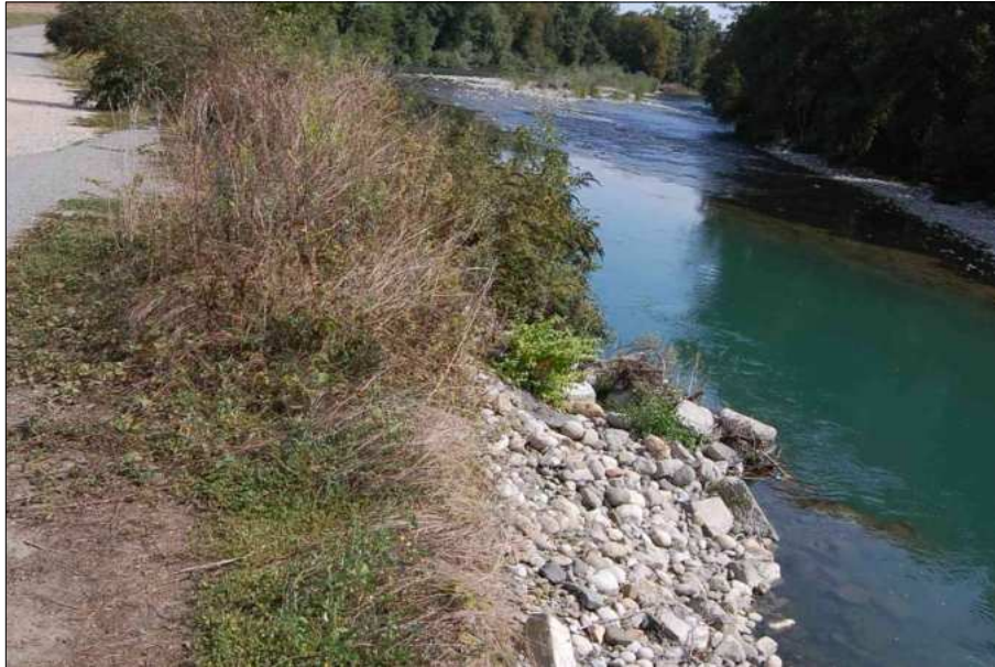
Figure n° 18 : commune de Villeneuve-de-Rivière Lors de la crue du 19 juin 2013, une partie de la route communale a été emportée au niveau du Moulin de St-Jean.
