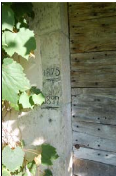
Photo n° 2 : Commune d'Estancarbon, le moulin de Linos. Les repères des crues historiques : crues des 23/06/1875 à 343.11 m, 03/07/1897 à 342.91 m et 19/06/2013 à 342.15 m.
