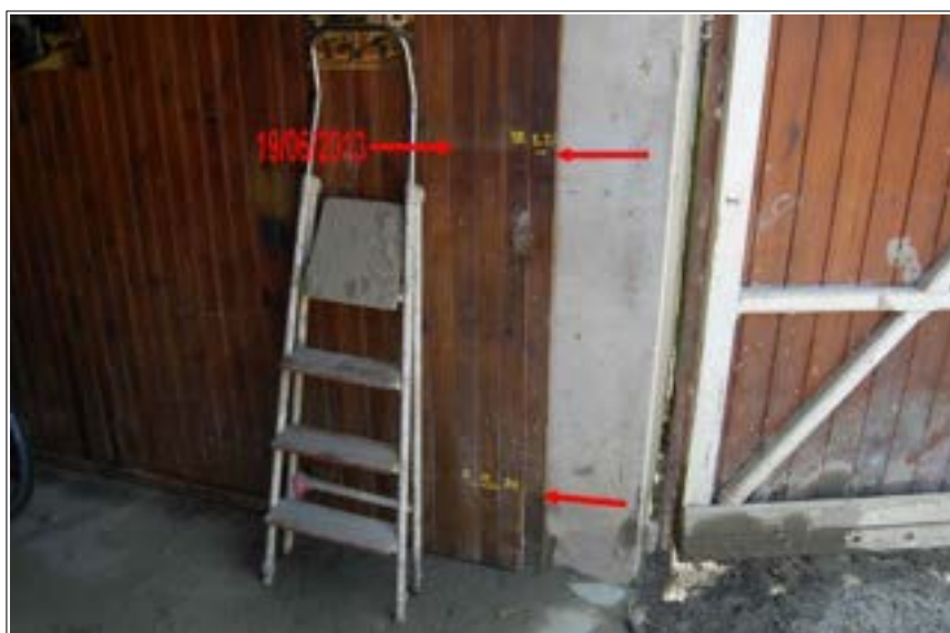
Photo n° 1 : Commune de Miramont-de-Comminges : au n°1 rue de Verdun. Dans le garage de la maison, il existe les traces de 3 crues : 19/06/2013 (1.28 m), 19/05/1977 (1.26 m) et 6/10/1992 (0.29 m).
