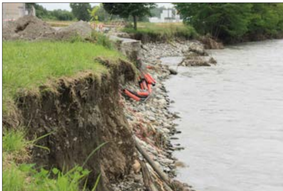
Figure n° 17 : commune de Valentine, lors de la crue du 19 juin 2013, une partie de la rue du château d'eau a été emportée au droit du dépôt EDF.
