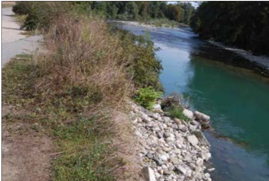
Figure n° 18 : commune de Villeneuve-de-Rivière Lors de la crue du 19 juin 2013, une partie de la route communale a été emportée au niveau du Moulin de St-Jean.
