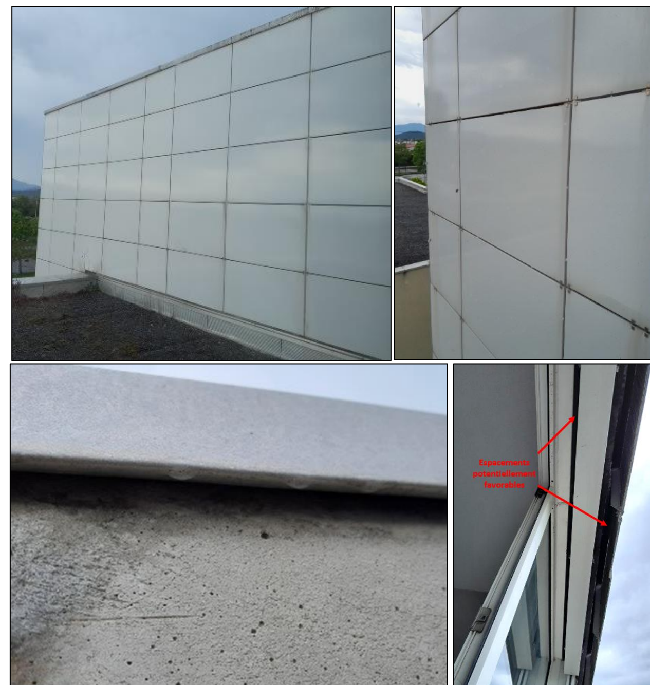
Figure 3 : Espacements entre les bardages (en haut) et au niveau des replis de couvertines (en bas à gauche) et espacements au niveau des fenêtres et des couvertines au-dessus de ces dernières (en bas à droite)
