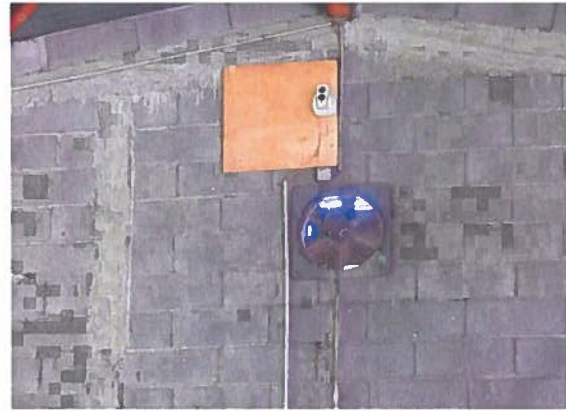
Détection incendie (IR) dans le garage
