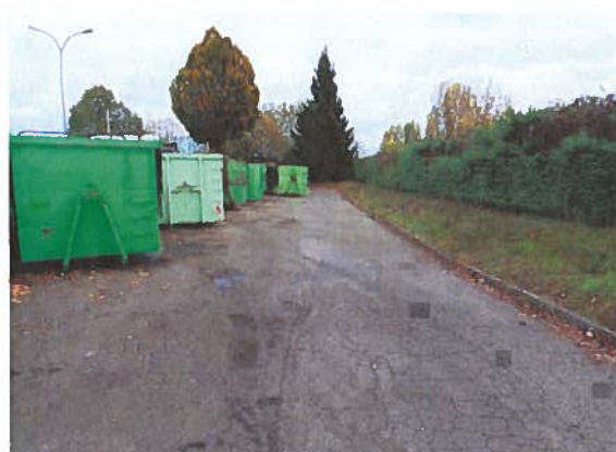
Enrobés bas de quais
