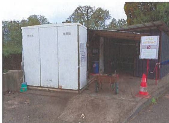
Armoire et local de stockage des déchets dangereux
