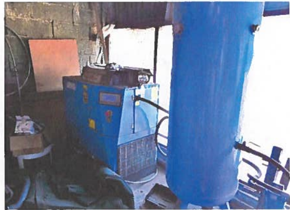
Compresseurs FINI de l'Atelier
