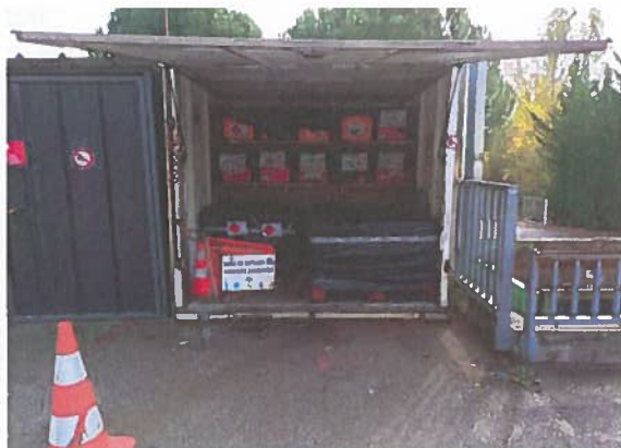
Armoire déchets dangereux (EcoDDS)
