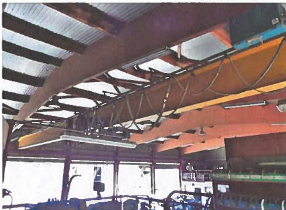
Pont roulant DEMAG (levage PL)
