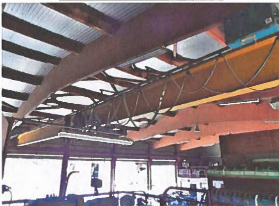
Pont roulant DEMAG (levage PL)
