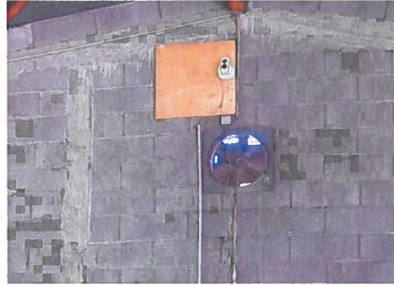
Détection incendie (IR) dans le garage
