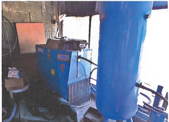
Compresseurs FINI de l'Atelier
