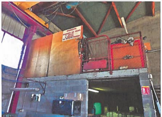
Local cuves à huile sur rétention et stockage matériel (R+1)
