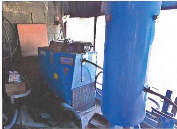
Compresseurs FINI de l'Atelier
