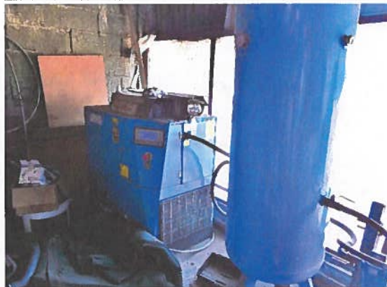
Compresseurs FINI de l'Atelier
