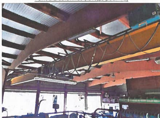
Pont roulant DEMAG (levage PL)
