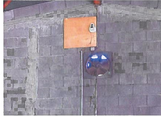
Détection incendie (IR) dans le garage
