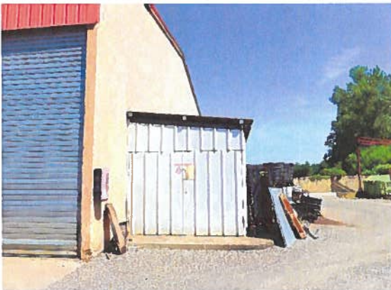
Local chaudière gaz accolée à l'Atelier
