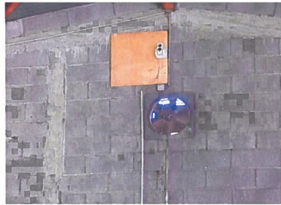
Détection incendie (IR) dans le garage
