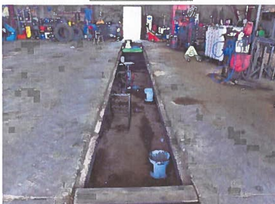
Fosse d'entretien sous le pont roulant PL
