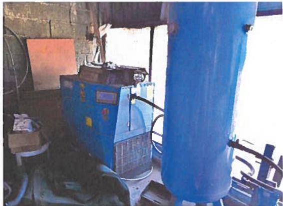
Compresseurs FINI de l'Atelier
