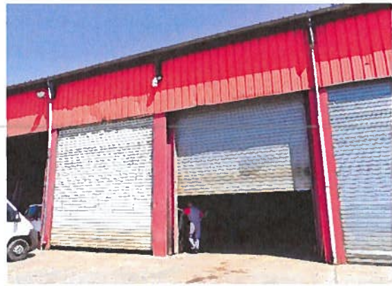
Rideaux métalliques de l'Atelier
