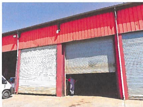
Rideaux métalliques de l'Atelier
