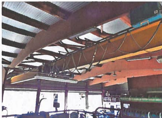
Pont roulant DEMAG (levage PL)
